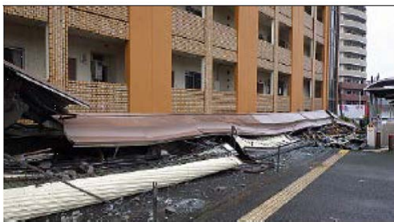
1 階の階層が座屈
